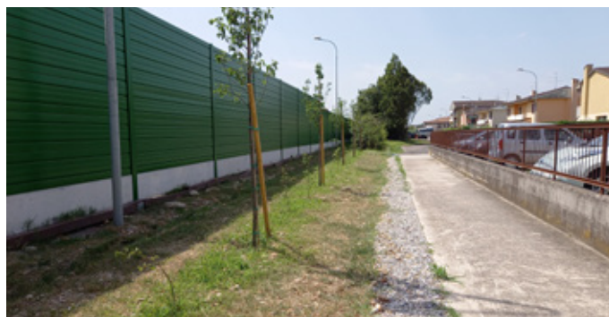
Barriera acustica installata
