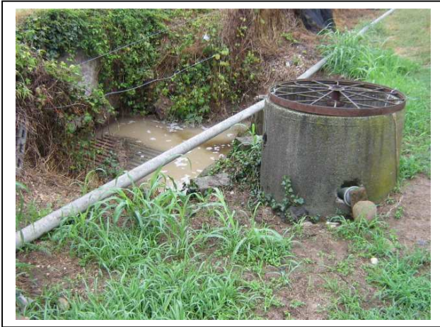
Scolo a margine stradale nei pressi del Rio Ferriadon dopo un evento particolarmente piovoso.
